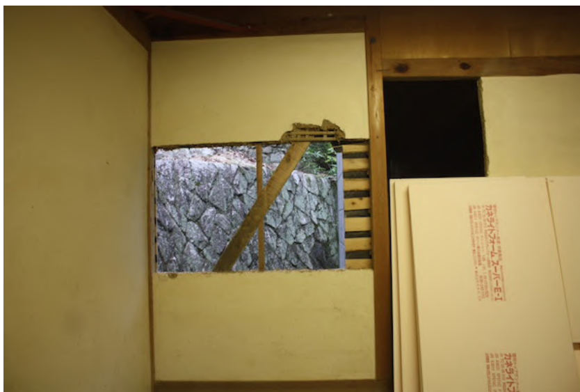
・壁を切ったら筋交いが出てきた窓。
